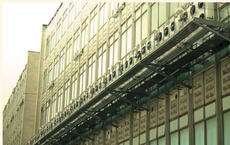
Балкон для наружных блоков кондиционеров четвертого зала
